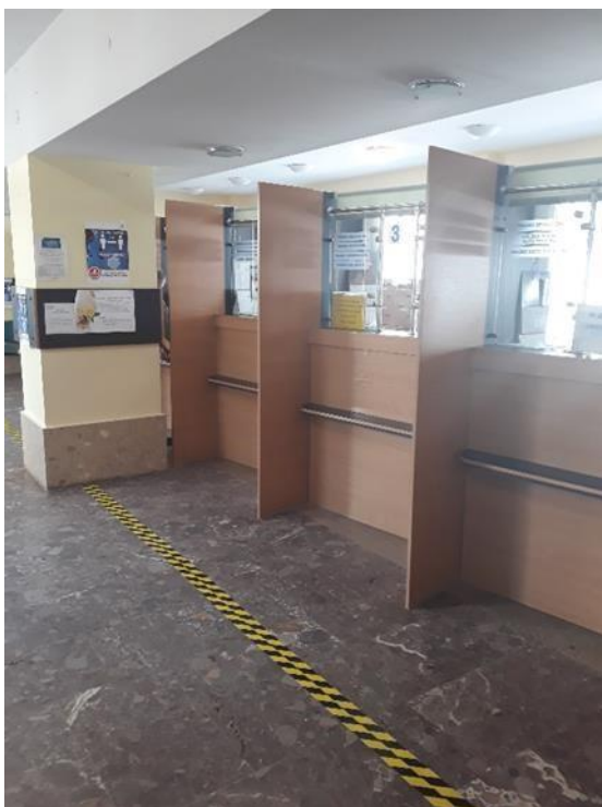
Zdjęcie nr 8. Brak obniżenia lady w rejestracji
